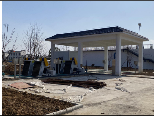
格栅提升泵池
